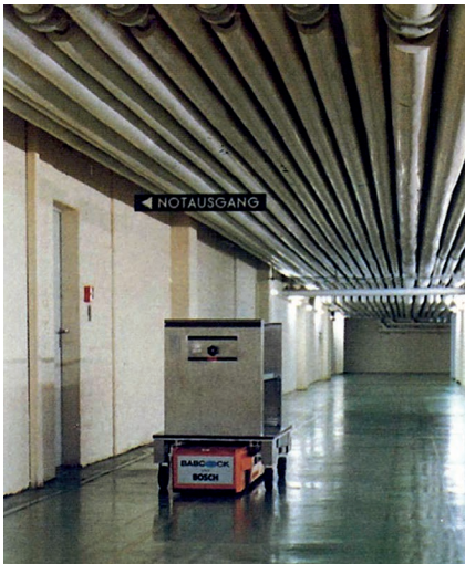
Abb. 6: Fahrt durch einen Versorgungsgang [5]
