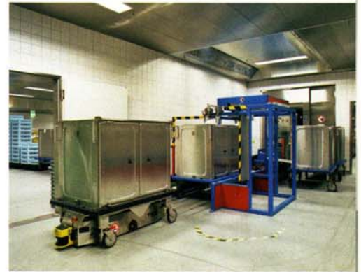
Ein FTF bringt einen leeren AWT-Container zur Waschmaschine. Dort führt ein Lasersystem eine Innenraumüberprüfung durch und lässt nur wirklich leere Container in die Waschmaschine.
