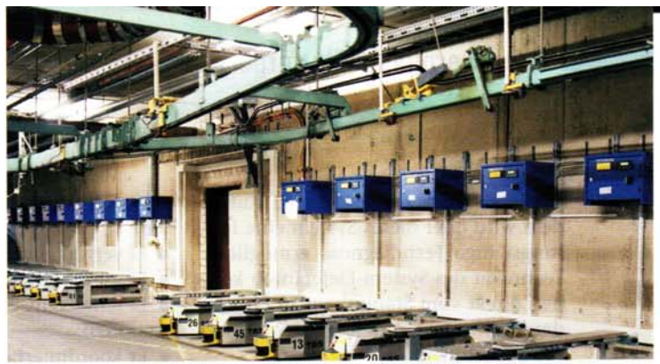
Bild 3 Jedes FTF hat einen Batterieladepplatz. Unter der Decke sieht man noch den abgehängten Stahlbau des alten Kreis Kettenförderers, der mittlerweile demontiert ist.
